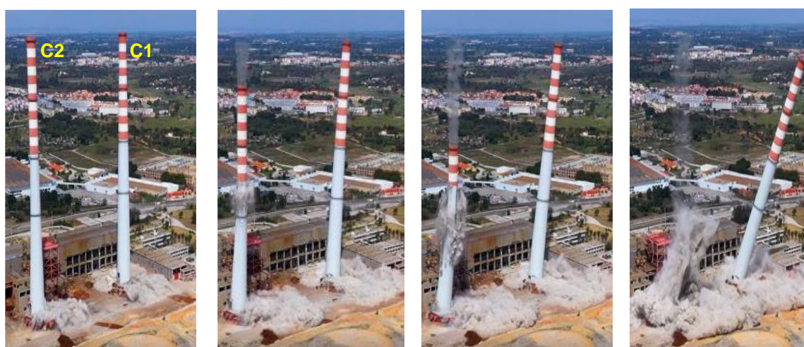
Figura 6.17 - Derrubamento da chaminé C1 por falha do estado de equilíbrio (AMBIGROUP, 2020)
