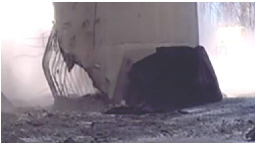
Figura 6.7 - Armadura exposta após a implosão (Mackenzie, G. J. e Samali, B. (2017))
